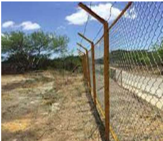
FIGURA 141. CERCO PERIMETRAL DE METAL. FUENTE: M.Sc. Efraín Medina Guerra
